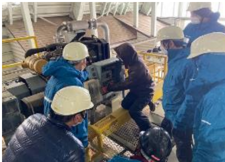
【予備原動機切替訓練】
