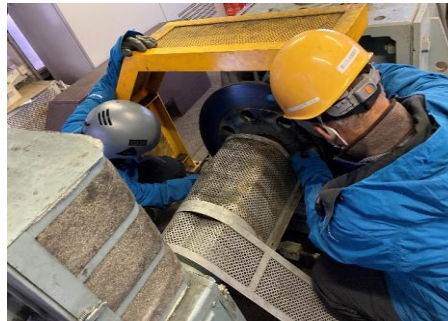
【予備原動機切替訓練】
